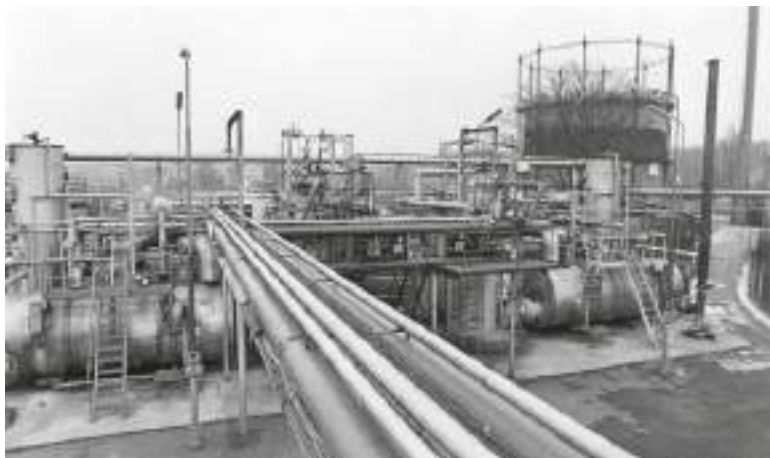
Spaltegasanlægget i 1980. Anlægget skulle oprindeligt etableres i elværksbygningen, men blev i stedet opført i fri luft efter eksplosionen på gasværket i Valby i 1964. Roskilde Lokallhistoriske Arkiv.
